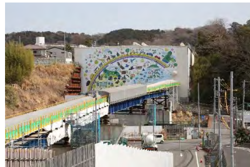
ベルトコンベア設置状況
