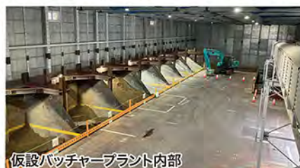
仮設バッチャープラント内部
