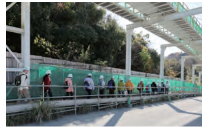
○工事現場内のベルトコンベアトンネル工事で掘削して発生した土砂を運搬しています。通常はトラックで運搬しますが、ベルトコンベアで運搬することにより、一般道を通行する工事車両台数の抑制につながります
