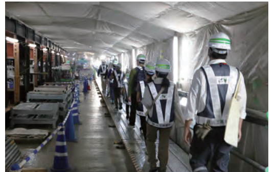
○釜利谷庄戸トンネル低土被り区間※ 住宅地が広がる地上部の影響を少なくするため、開削せずに非開削工法で施工中の低土被り区間を歩いて見学しました ※低土被り区間：トンネルの高さに対してトンネル上にかぶっている土の厚みが薄い区間
